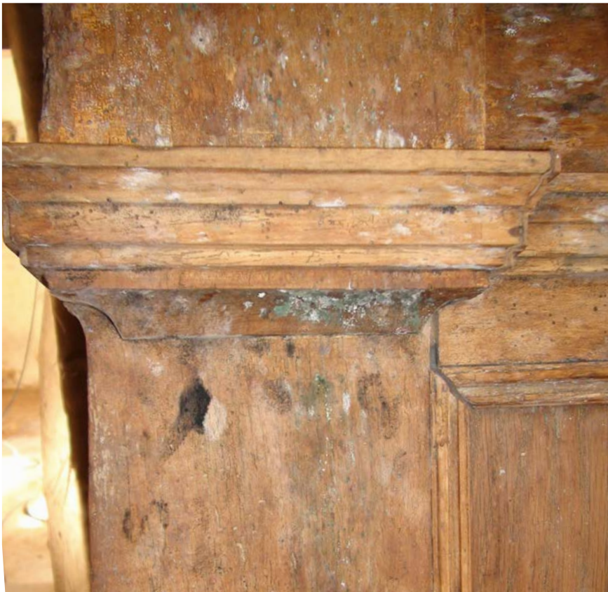
Abb. 12 Schimmelbildung auf einer Holzoberfläche durch hohe Luftfeuchtigkeit nach einer Überschwemmung
