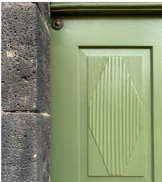
Abb. 6 Haustür von 1840 mit Leinölfarbanstrich.
