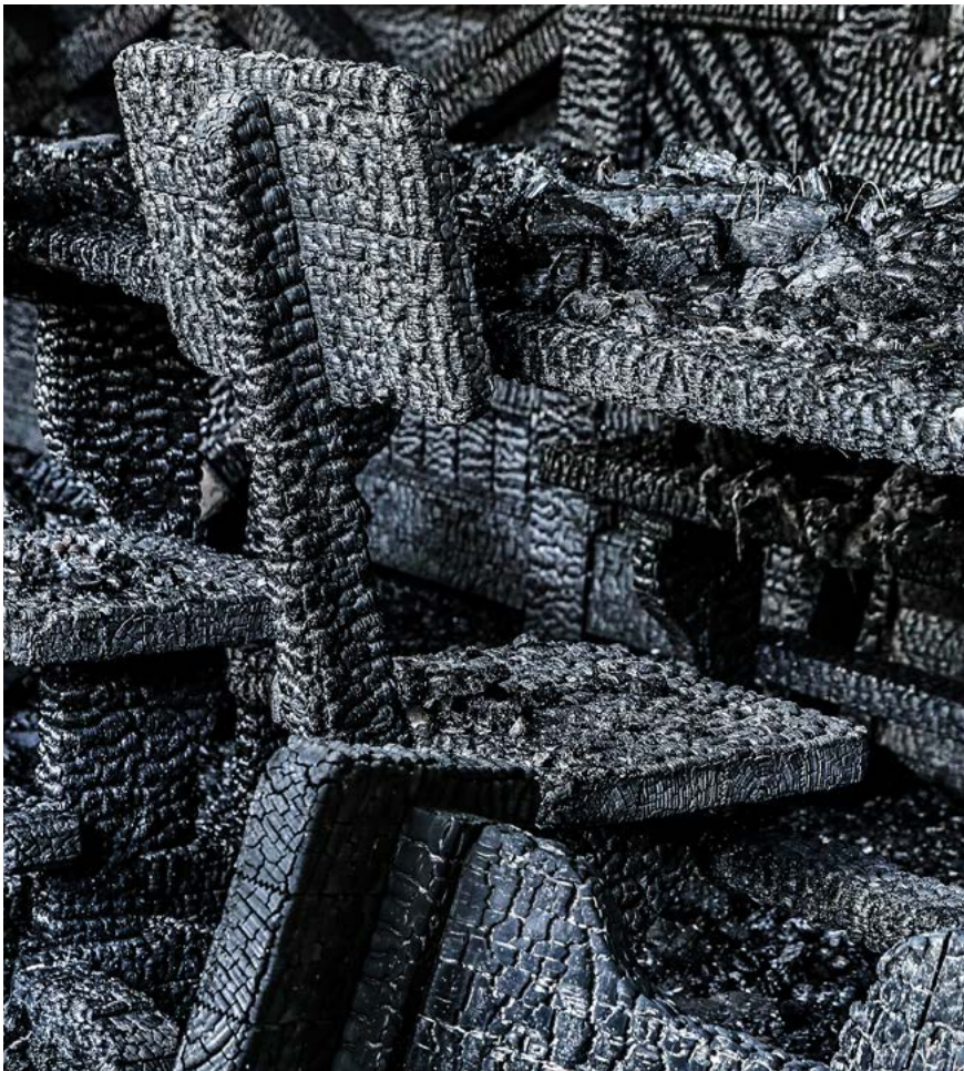
Abb. 4 Stark verkohltes, würfelbrüchiges Holz nach einem Brand
